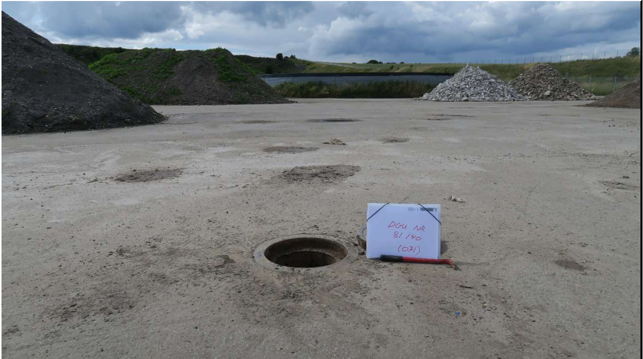
Foto 53: Boring DGU Nr. 81.140 (O71) er placeret i terræn under Ø40 støbejernsdæksel, ca. midt på pladsen. Afstand fra dæksel til nordlig hegn er ca. 42 meter, og afstand fra opsamlingsbeholder til dæksel er ca. 36 meter.
