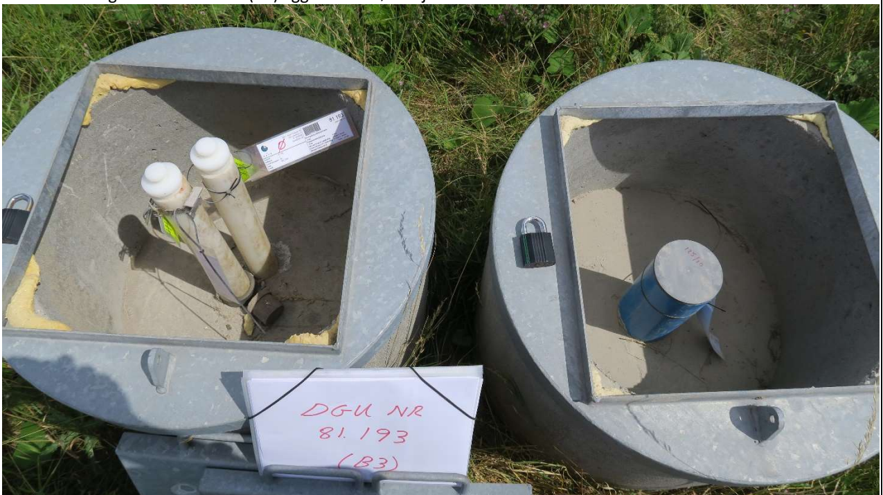
Foto 22: Boring DGU. Nr. 81.193 (B3) har 3 indtag, placeret i 2 stk. Ø600 betonrør med støbt bund og 50 cm firkantet galvaniseret låg. Indtag 1 er Ø125, Indtag 2 og indtag 3 er Ø63.
