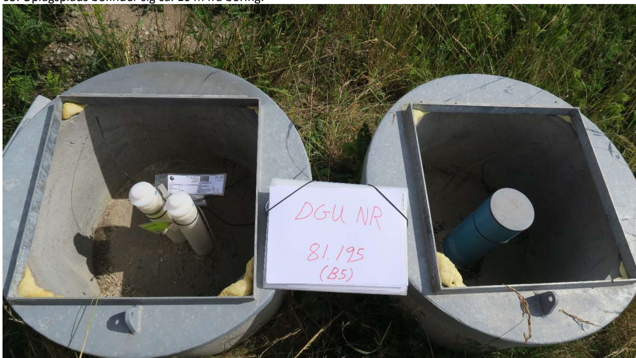
Foto 26: Boring DGU Nr. 81.195 (B5) består af 2 stk. Ø600 betonrør med støbt bund og 50 cm firkantet galvaniseret låg. Der er 3 indtag. Indtag 1 er Ø125. Indtag 2 og indtag 3 er Ø63.
