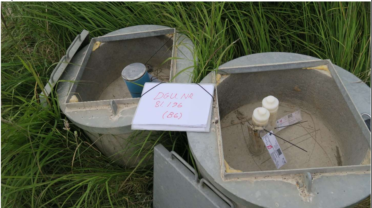
Foto 28: Boring DGU. Nr. 81.196 (B6) har 3 indtag, placeret i 2 stk. Ø600 betonrør med støbt bund og 50 cm firkantet galvaniseret låg. Der er 3 indtag. Indtag 1 er Ø125. Indtag 2 og indtag 3 er Ø63.
