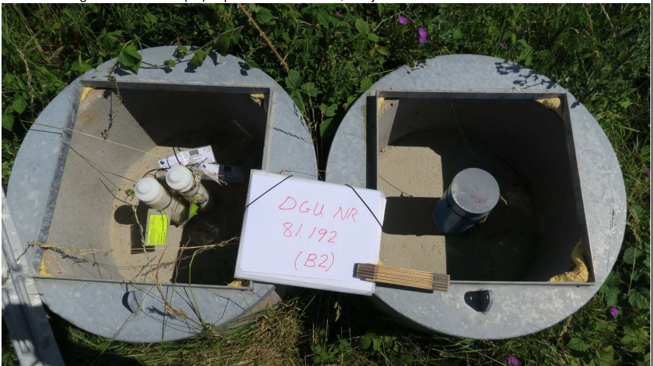
Foto 20: Boring DGU. Nr. 81.192 (B2 har 3 indtag, placeret i 2 stk. Ø600 betonrør med støbt bund og 50 cm firkantet galvaniseret låg. Indtag 1 er Ø125, Indtag 2 og indtag 3 er Ø63.
