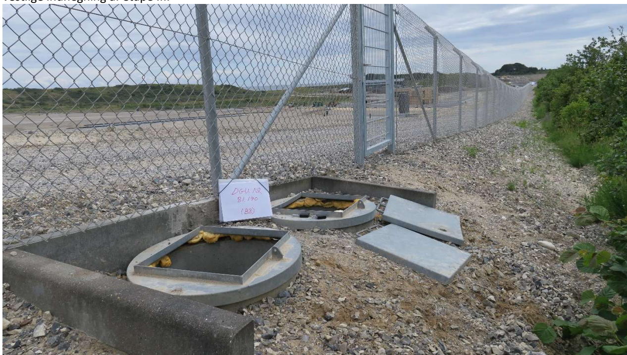
Foto 31: Boring DGU. Nr. 81.190 (B8) er placeret uden for vestlig indhegning etape III, ved låge. Boringen har 3 indtag, placeret i 2 stk. Ø600 betonrør uden støbt bund og 50 cm firkantet galvaniseret låg.
