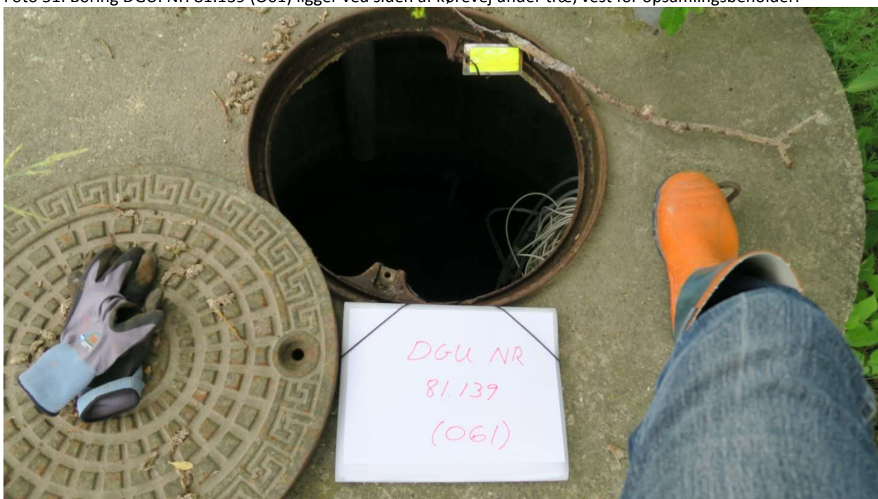
Foto 52: Boring DGU. Nr. 81.139 (O61) er udført i Ø125 filterrør, placeret i Ø1500 betonringe med støbt bund og betonlåg med Ø60 mandehul.
