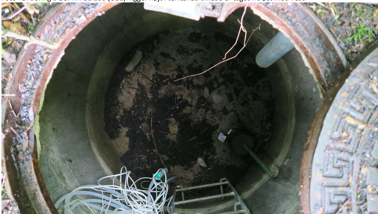
Foto 46: Boring DGU. Nr. 81.136 (O31) er udført i Ø125 filterrør, placeret i Ø1500 betonringe med støbt bund og betonlåg med Ø60 mandehul.
