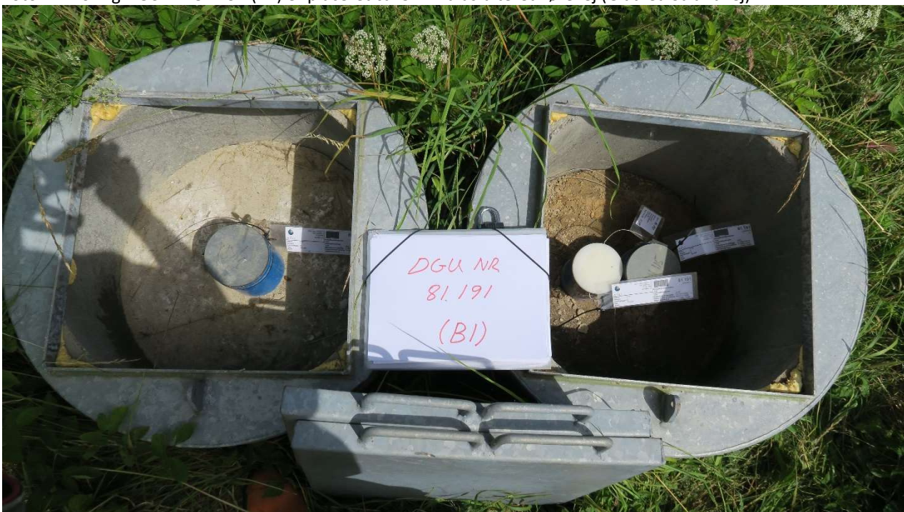
Foto 18: Boring DGU Nr. 81.191 (B1) har 3 indtag, placeret i 2 stk. Ø600 betonrør med støbt bund og 50 cm firkantet galvaniseret låg. Indtag 1 og indtag 2 er Ø125, Indtag 3 er Ø110.
